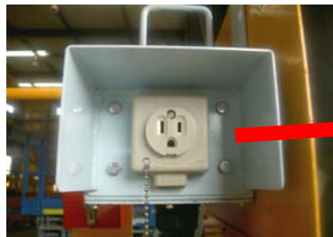
カバー付きのコンセント部
