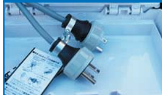
発電機搭載装置(配線)
